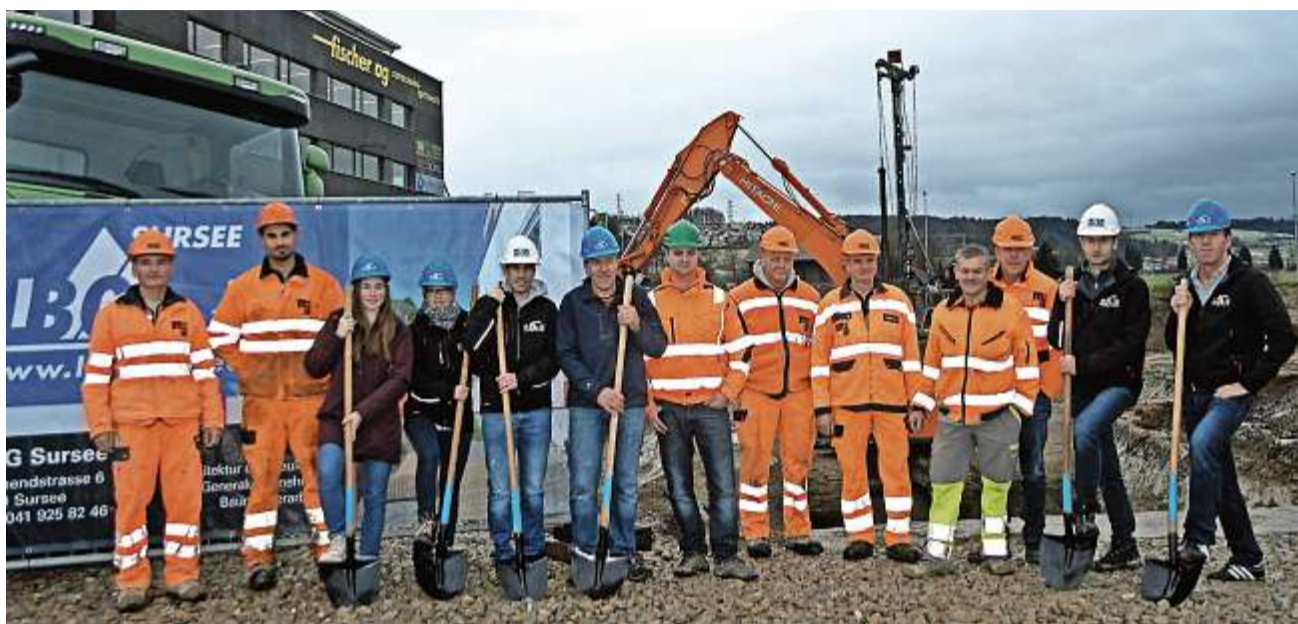
Bei nasskaltem Wetter wurde der Spatenstich für das Grossprojekt in Schenkon vollzogen.
